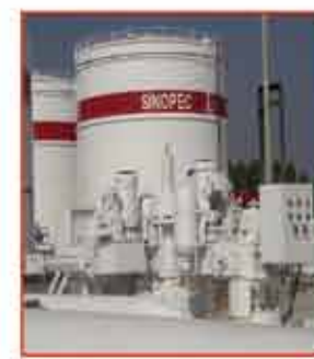
罐区电液动控制阀
